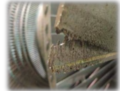
Erosión por gotas de agua
