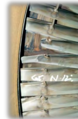
Daño en álabes
