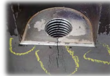
Grietas en la carcaza
