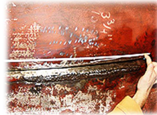
Grietas inducidas por “water piston” en un desaireador (Imagen de Kansas City Dearator Company)
